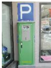
Die erste E-Tankstelle in der Weststeiermark: Elektro Theisl hat die Kompetenz, um die Mehler-E-Zapfsäulen zu installieren.
